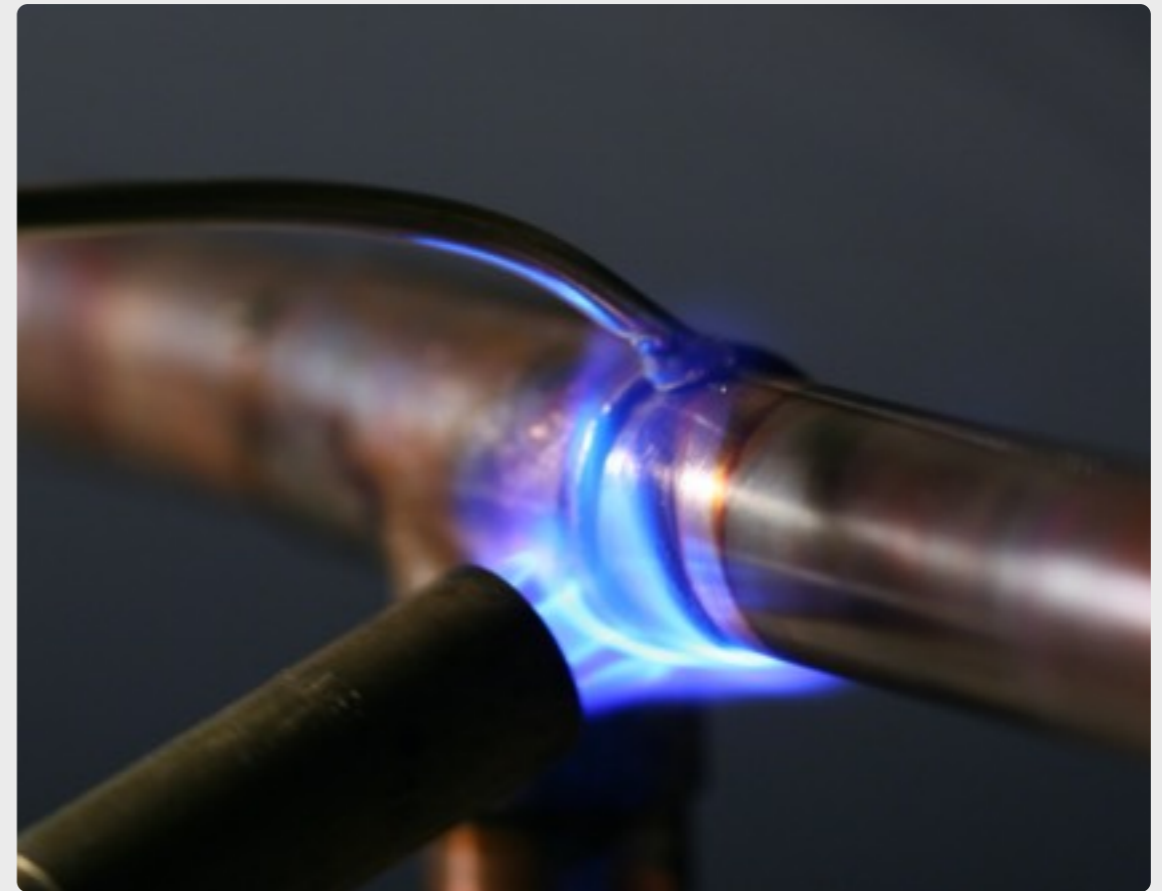
Esempio di brasatura su un tubo di rame
