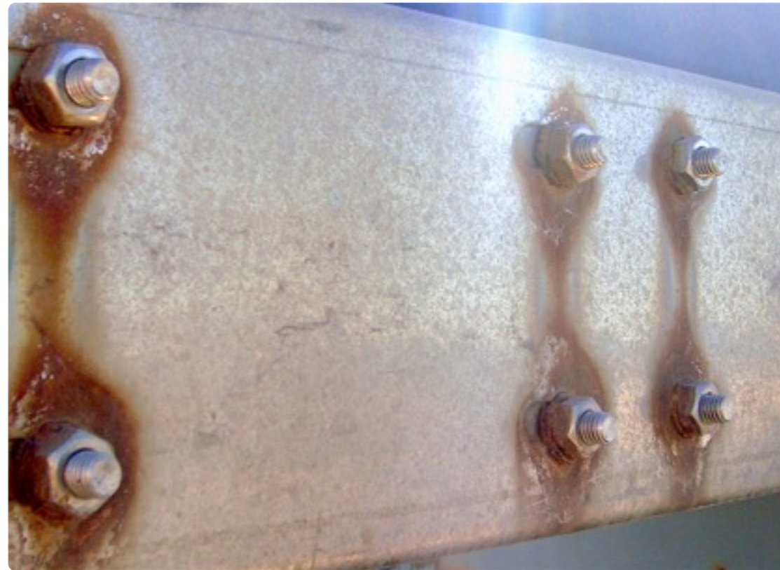
Esempio di corrosione galvanica
