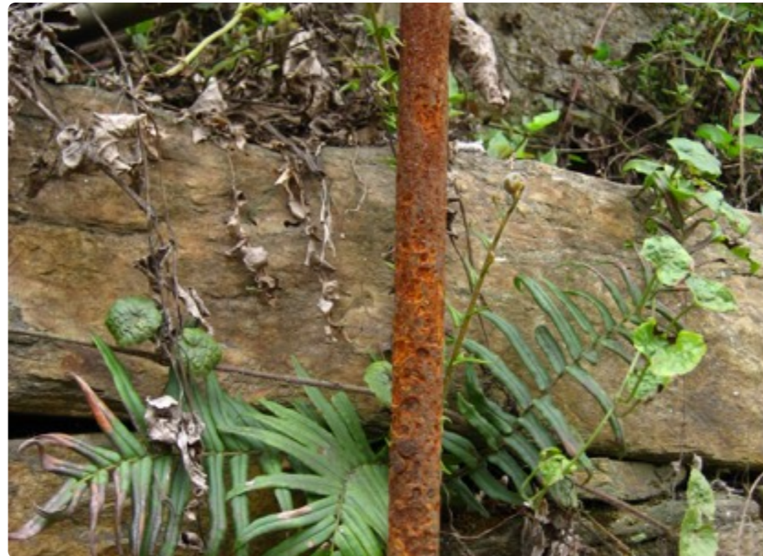
Corrosione dovuta all'azione dell'ambiente atmosferico esterno.
